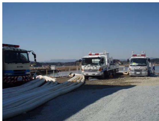
排水ポンプ稼働状況確認 (4/6)
