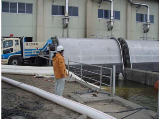
排水ポンプ稼働状況確認 (4/4)
