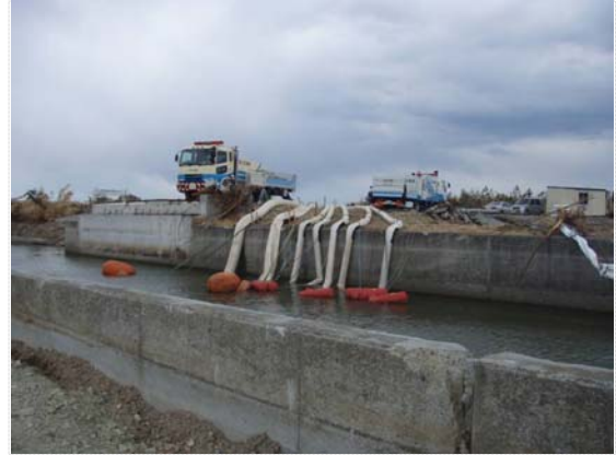
排水ポンプ稼働状況 (4/4)
