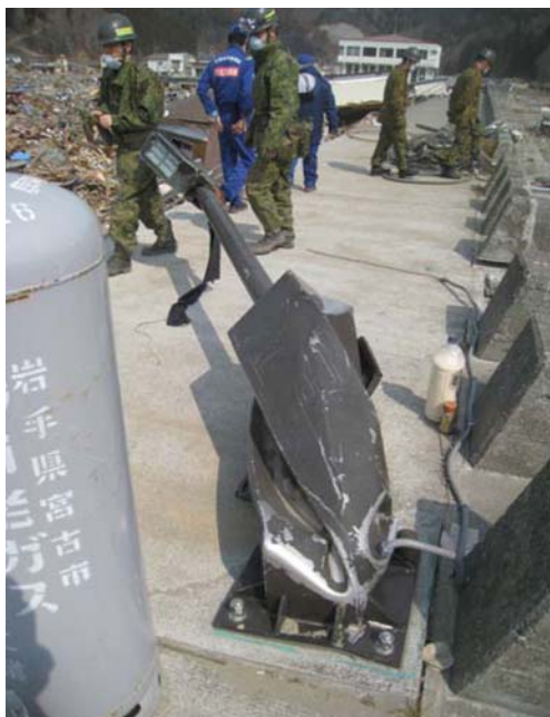
リエゾン活動状況・折れた照明柱 (4/2)
