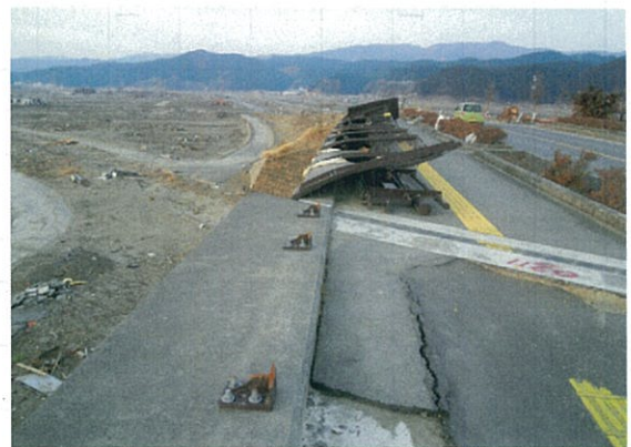
陸前高田市内被災状況
