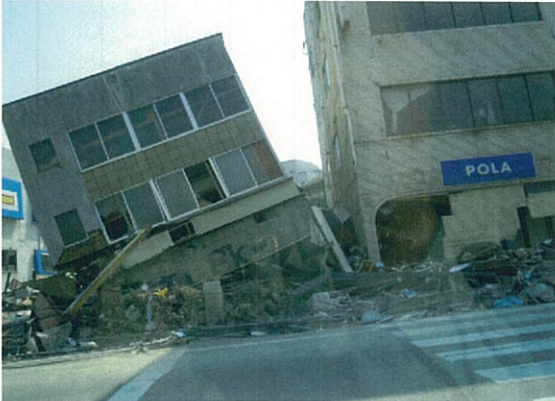
釜石市内被災状況
