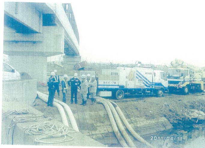
⑬ 国土交通省の排水ポンプ車
