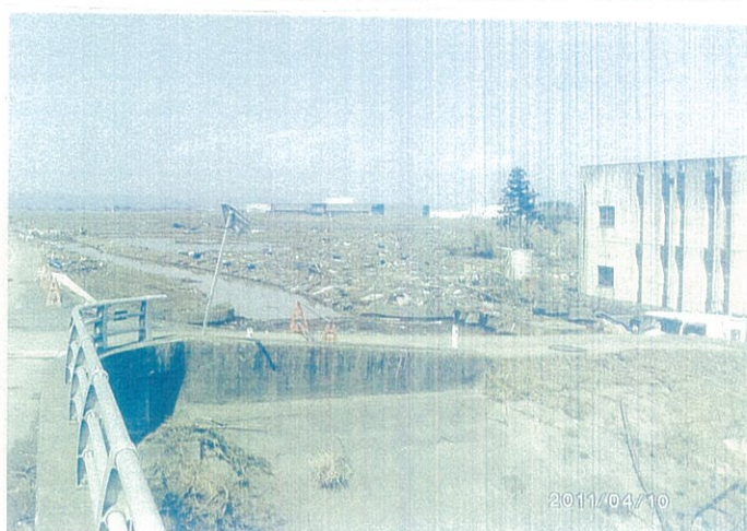
⑫ 左記と同じ：藤曾根排水機場（停止中）と堤内水路
