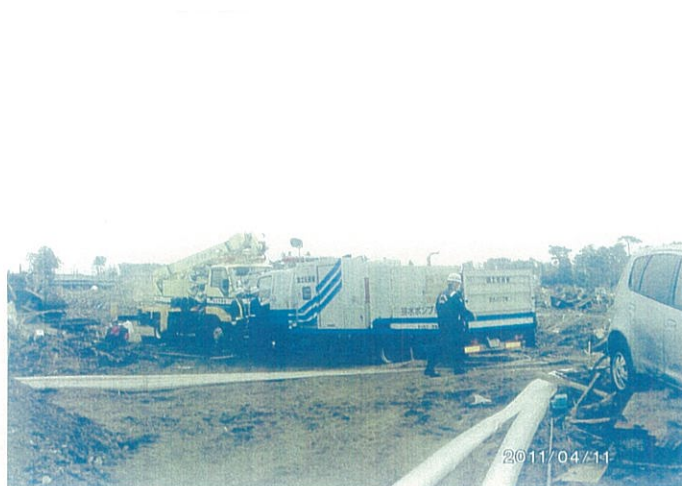
⑮ 排水ポンプ
