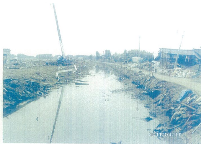
⑯ ポンプ排水を行っている水路：水位が下がっている
