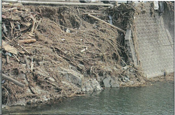
釜谷川護岸の崩壊状況
