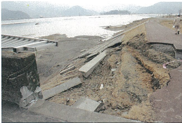
北上大橋護岸崩壊状況
