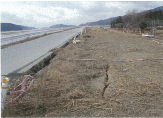
右岸天端亀裂状況
