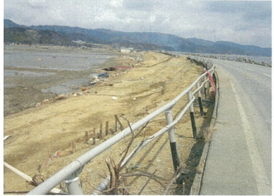
橋浦堤防 左岸堤内側法面崩落状況
