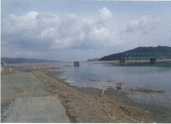
新北上大橋(トラス橋)崩壊状況
