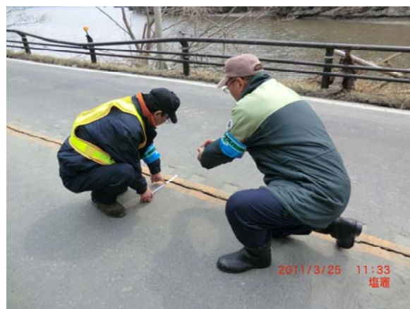
クラック幅の調査
