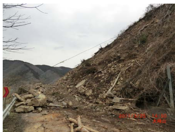
土砂崩れによる通行止め箇所
