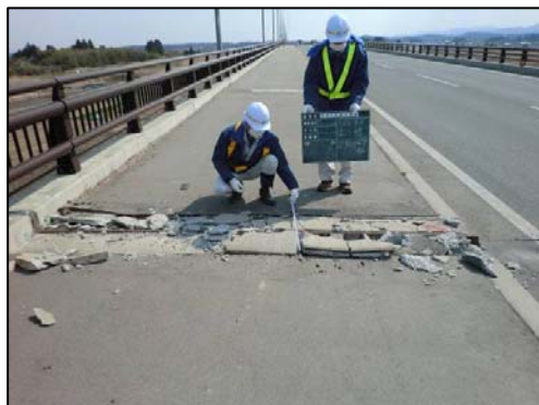
相馬 BP 298.19(kp) 宇多川橋 伸縮装置損傷
