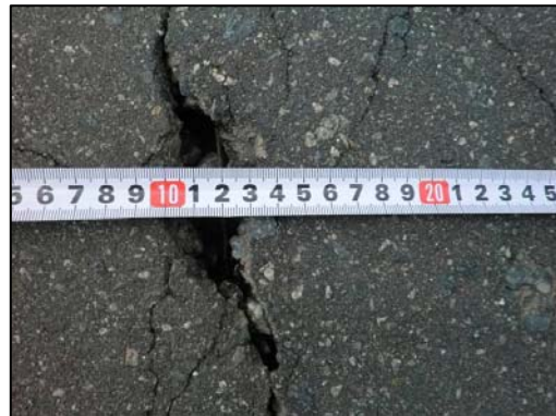
国道 286.7(kp) 車道クラック
