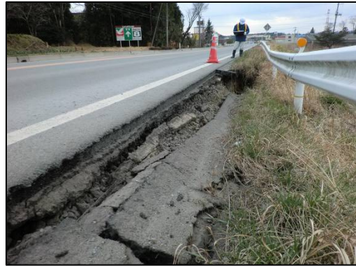
国道 303.47(kp) 路肩崩落
