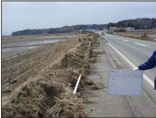
国道 308.3(kp) 防護柵倒伏
