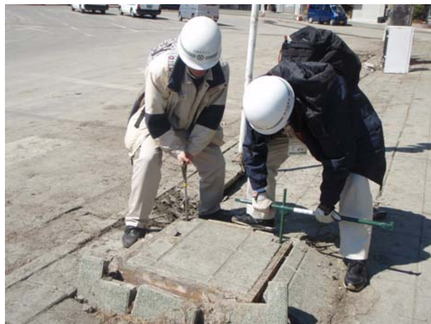
マンホールの浮き上がり（J R松島海岸駅前）
