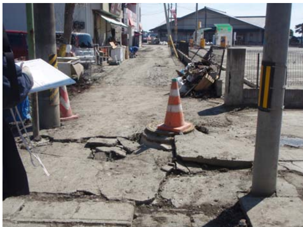
マンホールの浮き上がり（観覧邸付近）
