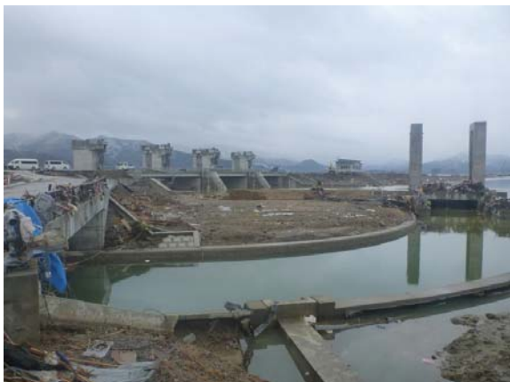
水門下流川からの被害状況
