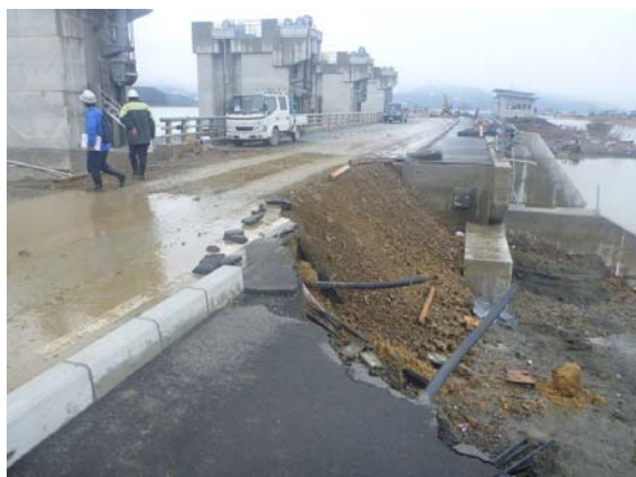
水門側部の堤体被災状況（近景）
