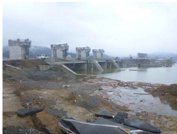
水門側部の堤体被災状況（遠景）
