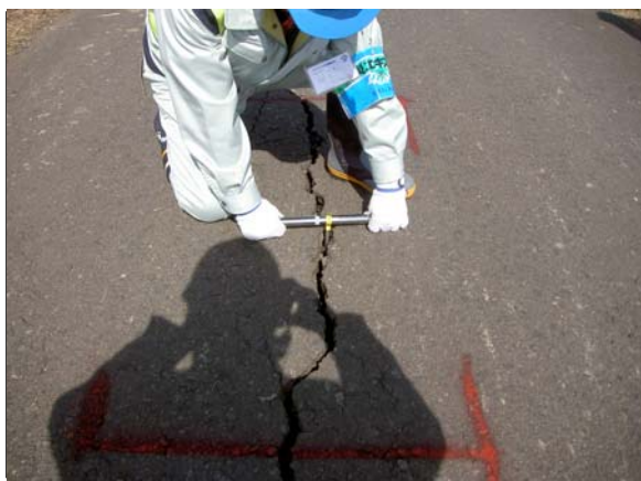
名取川左岸天端クラック深さ確認状況 鉄筋棒挿入（クラック深さ1m以上）
