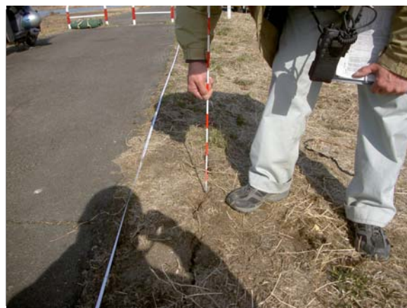
名取川左岸天端クラック確認状況 クラック深さ L=35cm
