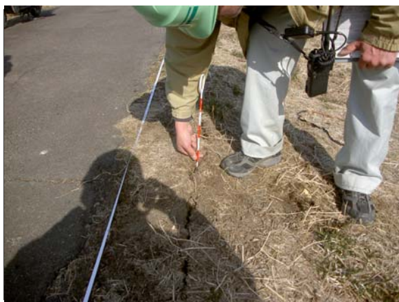
名取川左岸天端クラック確認状況
