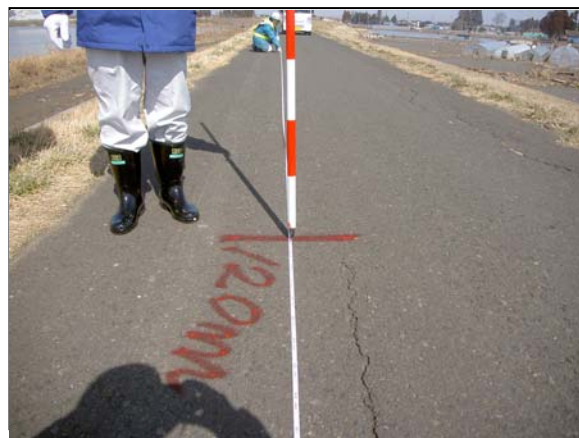
名取川左岸天端クラック延長測定状況
