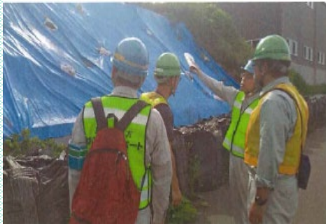
▲仙台河川国道管内
