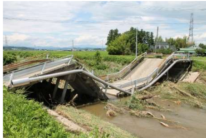
▲大崎市丸山橋被災状況（7月18日）
