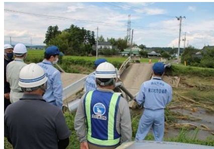
▲丸山橋被災状況調査（7月18日）
