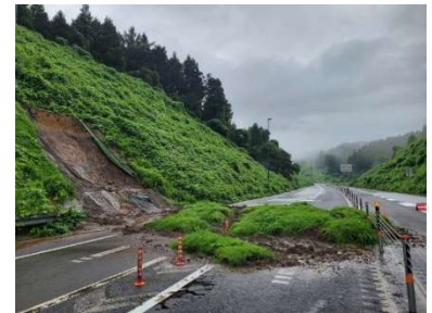
▲日本海沿岸東北自動車道 法面崩落 による通行止め(由利本荘市 8月13日)
