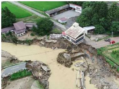
▲主要地方道大巻橋被災状況（飯豊町）
