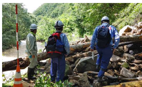
▲道路被災状況調査(青森県鯉ヶ沢町) (町道赤石溪流線 8月17日)
