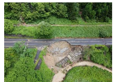
▲国道113号 道路流失状況 （山形県飯豊町 8月4日）
