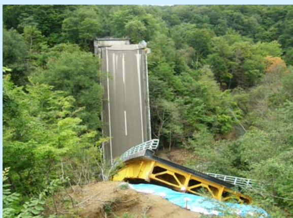
祭時[まつるべ]大橋(国道342号)の落橋
